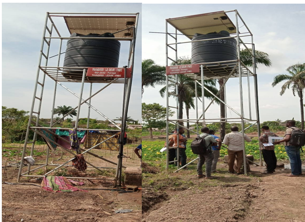
Planche 5 : Deux forages avec équipement solaires installés sur le site de maraichage de Parakou
