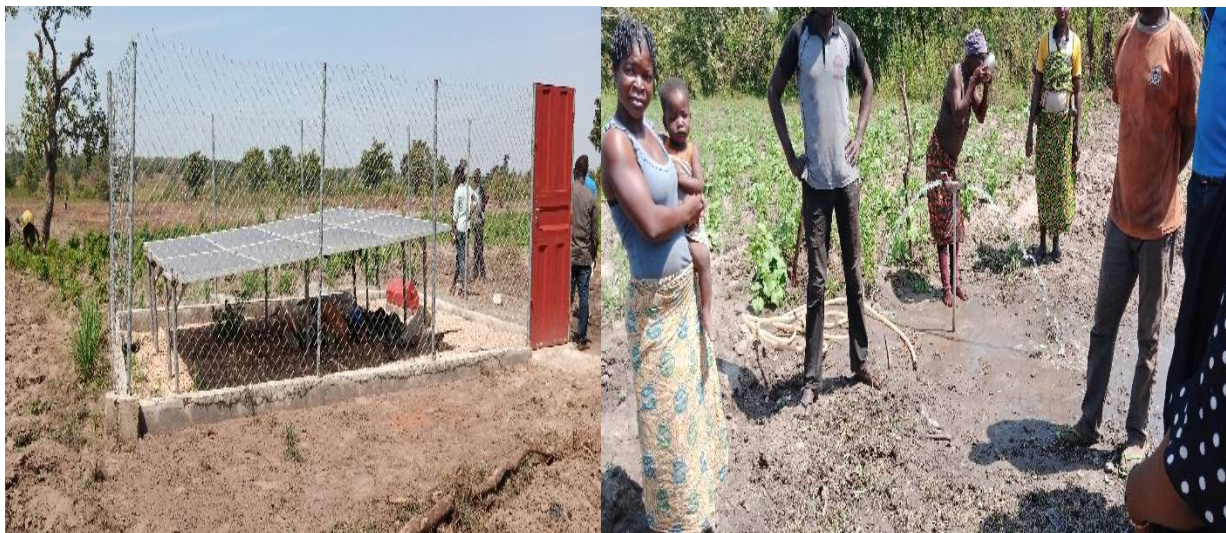
Planche 3 : Forage à équipement solaire réalisé sur le site de maraichage de Kera (Tchaourou)
