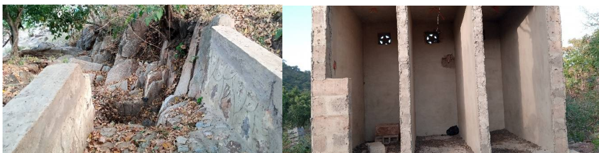
Planche 7 : Etat des travaux en cours de réalisation et abandonnés par l'entreprise dans la forêt Wèwèrè
